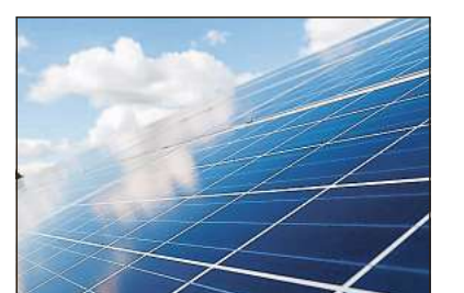
Damit der Strom von Photovoltaikanlagen auch eingespeist werden kann, verstärken die Stadtwerke jetzt die Netze in einigen Bereichen. Foto: Pixabay
